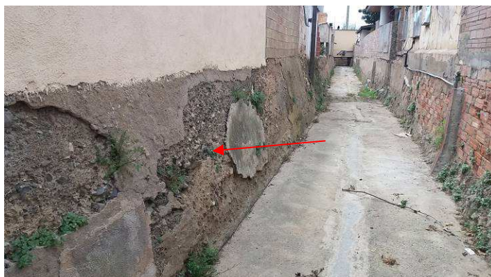
Estat actual del revestiment a reparar.
