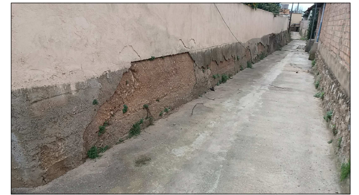
REVESTIMENT EN MAL ESTAT
