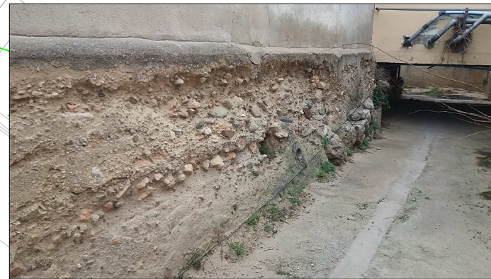
REVESTIMENT EN MAL ESTAT
