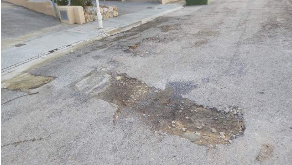
Trams en que la capa de rodadura pràcticament ha desaparegut
