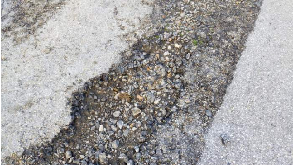
Trams en que la capa de rodadura està totalment deteriorada
