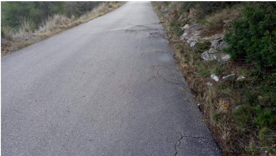
Bonys en laterals i capa de rodadura esquerdada
