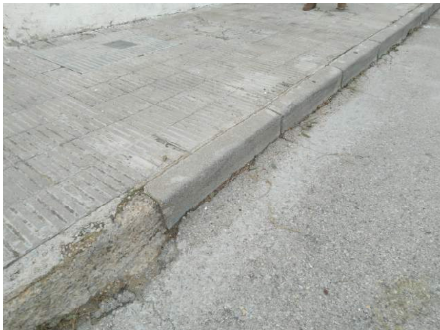
Punts de vorades en mal estat i encontre de vorada i asfalt esquerdat
