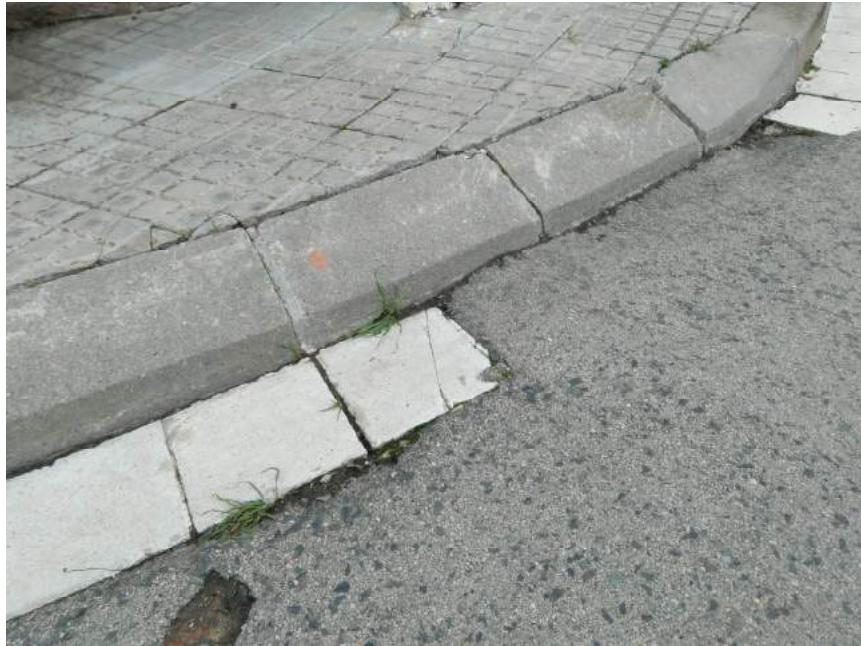
Capa de rodadura deteriorada en encontre amb la rigola
