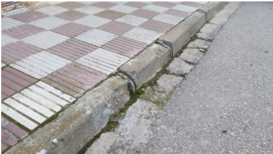
Trams amb trencament de rigola i vorades deteriorades
