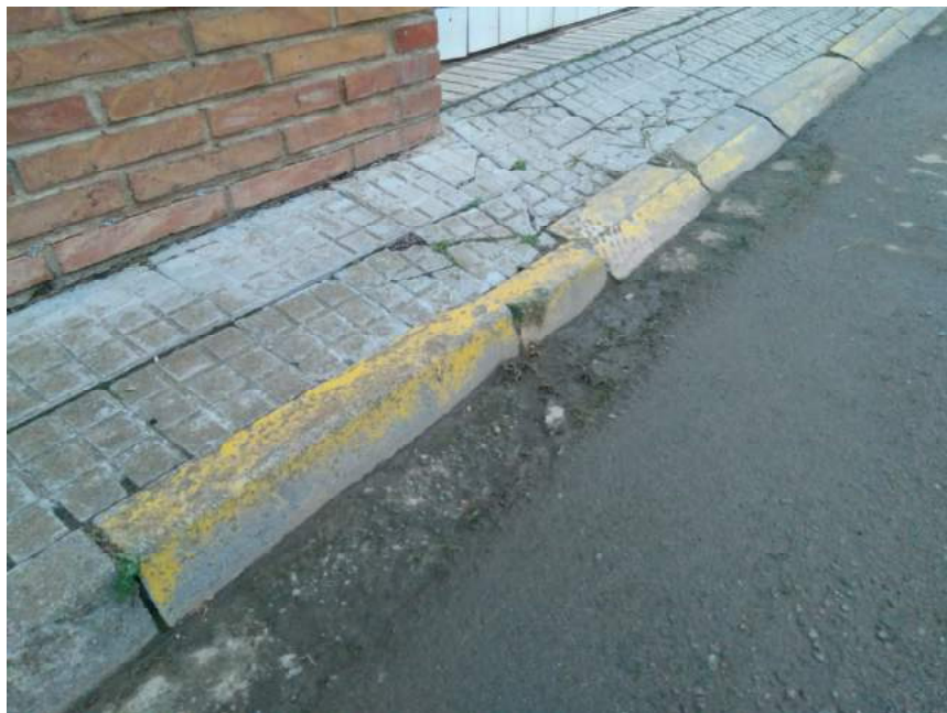
Punts de rigola i paviment de vorera en mal estat
