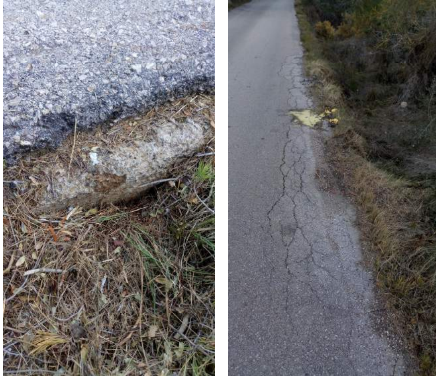
Extrems de la calçada esquerdatats i deteriorats
