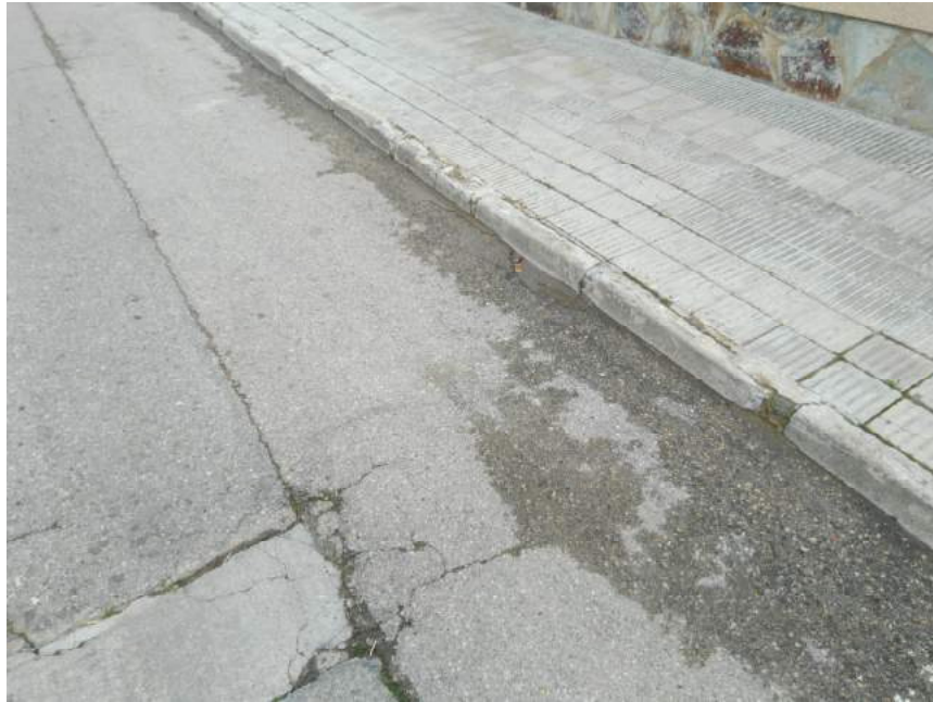
Capa de rodadura trencada
