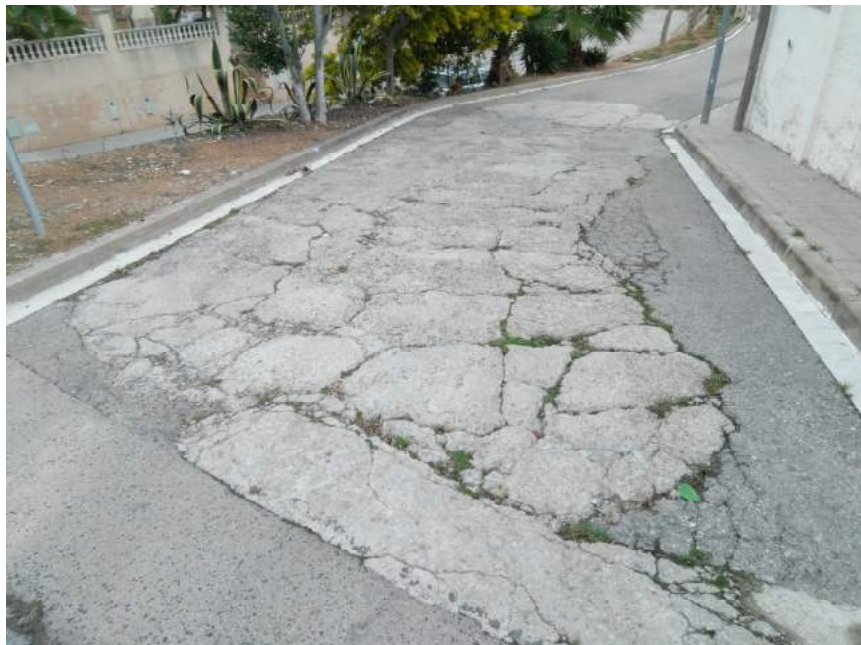
Trams d'anteriors reparacions completament esquerdats i deteriorats
