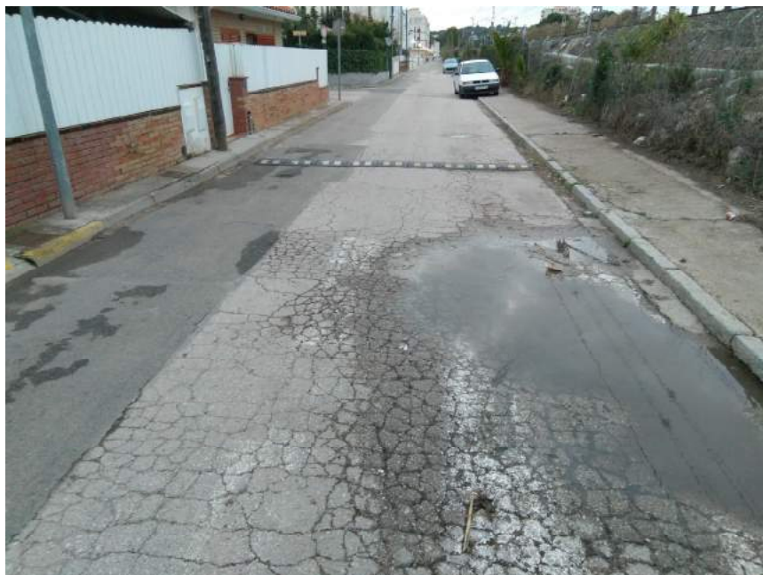
Flonjalls profunds amb capa de rodadura molt esquerdada
