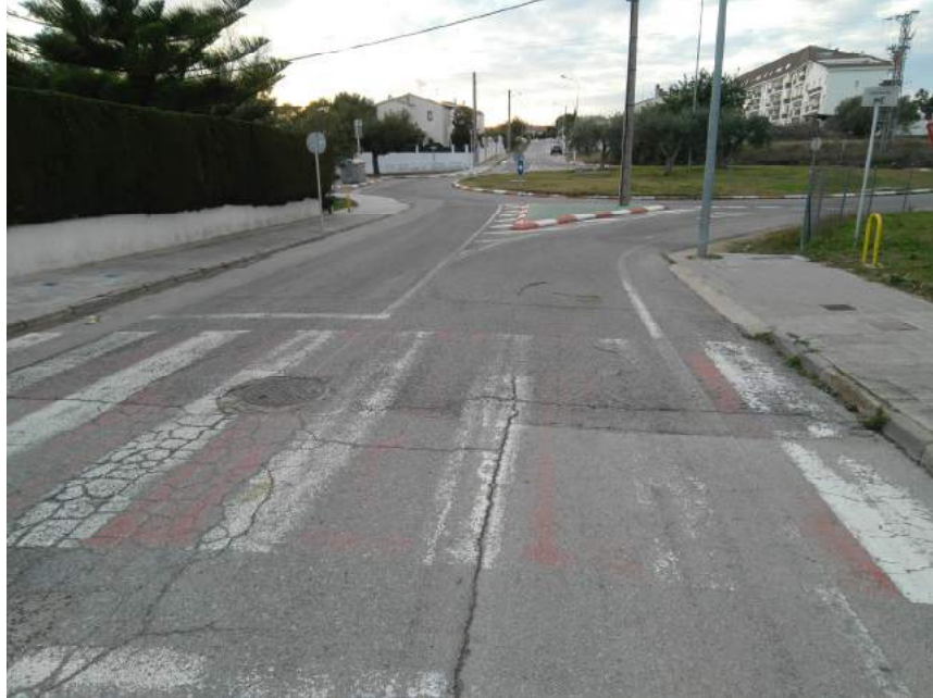
Capa de rodadura esquerdata i amb pell de cocodril
