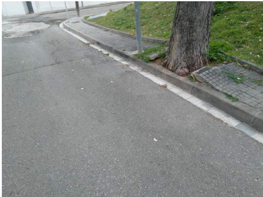
Desperfectes en calçada i vorera per arrels d'arbrat
