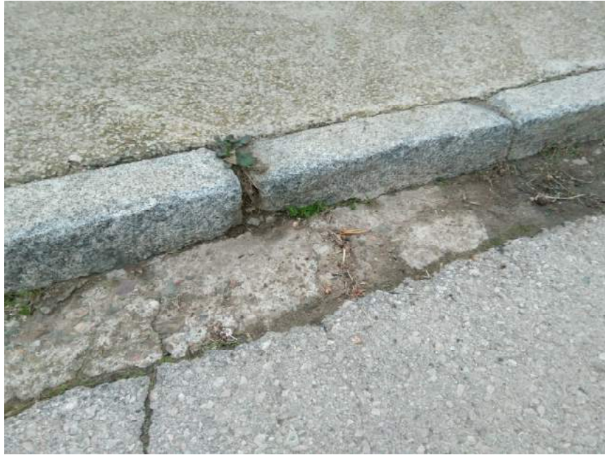
Rigola de formigó esquerdada
