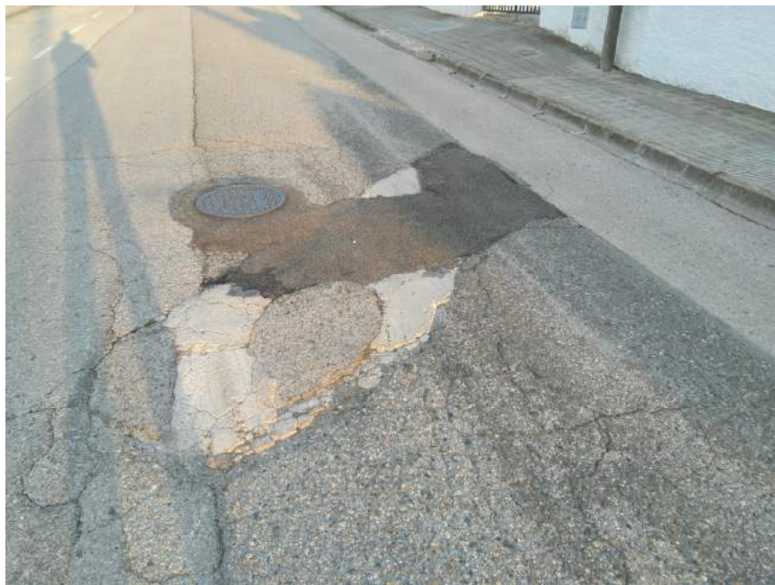
Capa de rodadura deteriorada per anteriors actuacions
