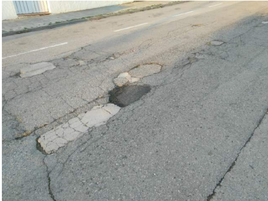
Capa de rodadura molt deteriorada i flonjalls
