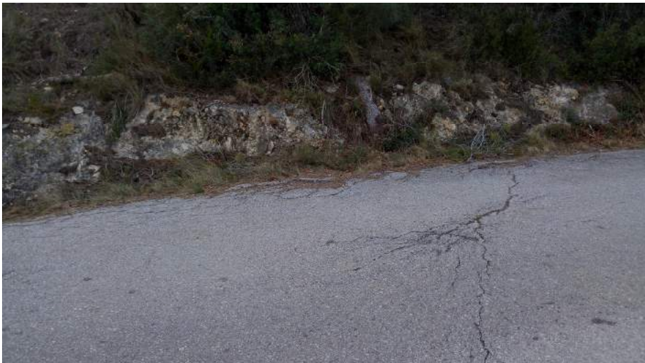
Capa de rodadura esquerdada
