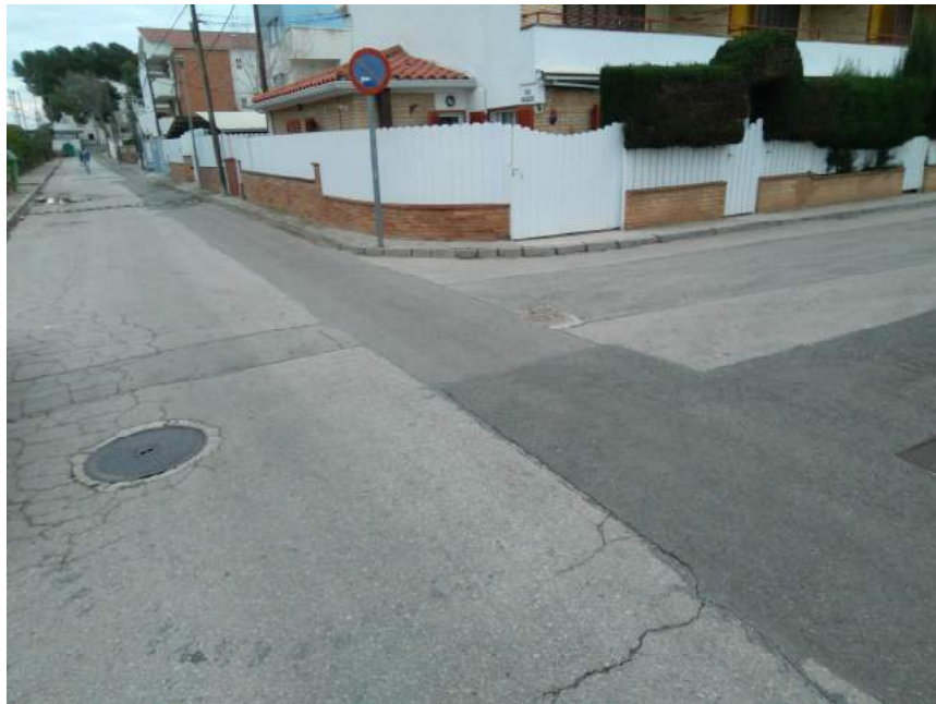
Capa de rodadura trencada en trams d'anteriors reparacions
