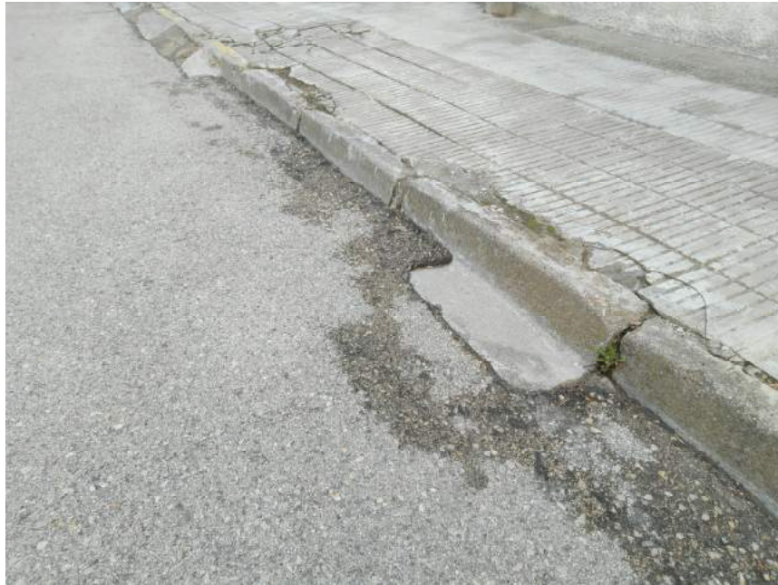
Trams amb rigoles, vorades i paviment de vorera deteriorats
