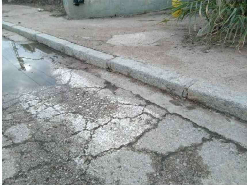
Capa de rodadura molt esquerdada i flonjalls
