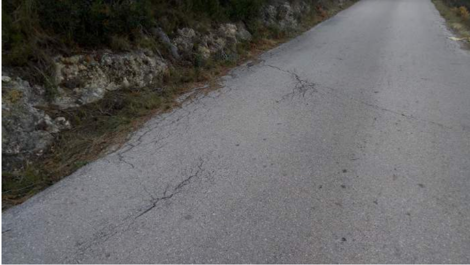
Capa de rodadura esquerdada
