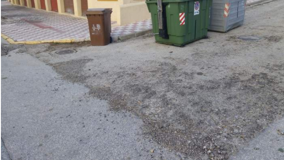
Tram amb capa de rodadura trencada i flonjalls
