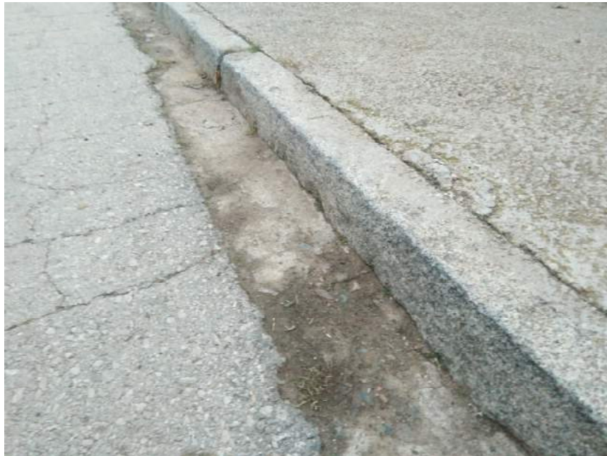
Rigola de formigó deteriorada
