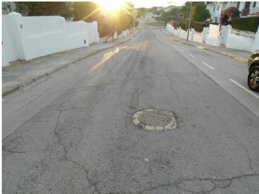
Capa de rodadura esquerdada i amb pell de cocodril i presència d'actuacions anteriors
