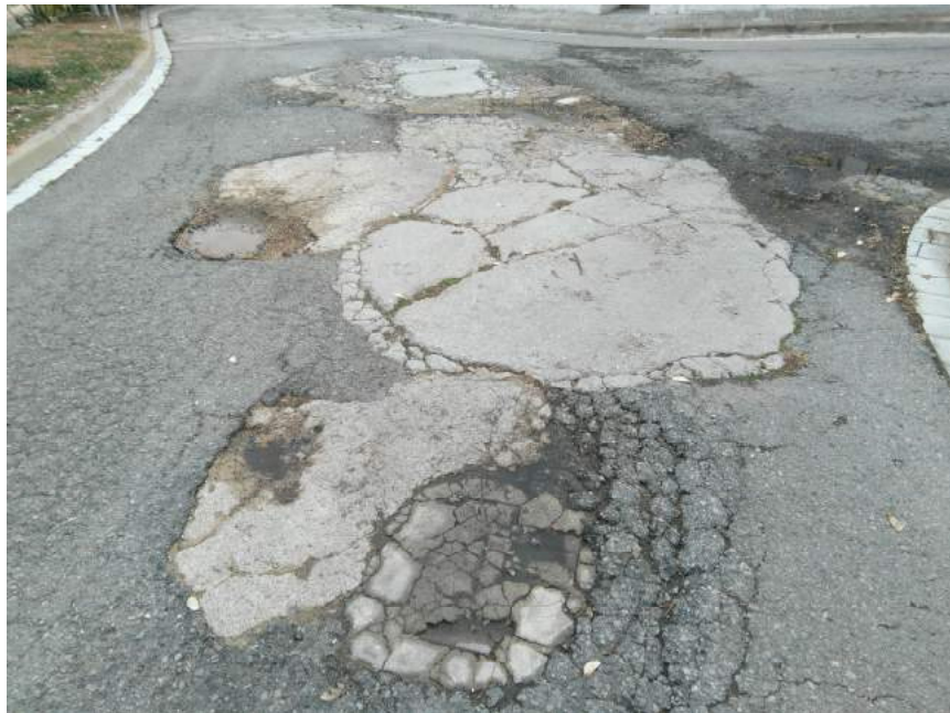
Trams d'anteriors reparacions molt deteriorats i amb flonjalls
