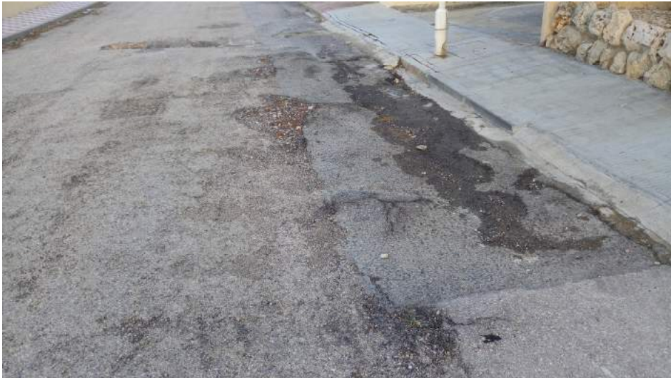
Capa de rodadura molt deteriorada, esquerpada, i rasa al lateral dret
