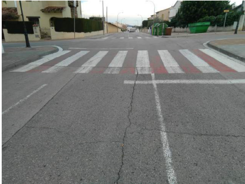
Capa de rodadura esquerdada
