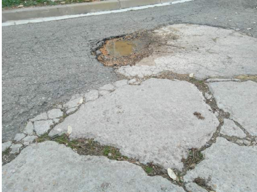
Trams d'anteriors reparacions completament esquerdats i deteriorats i flonjalls profunds
