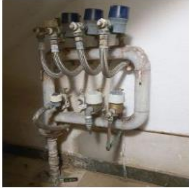
Imatge 1: Bateria de comptadors
