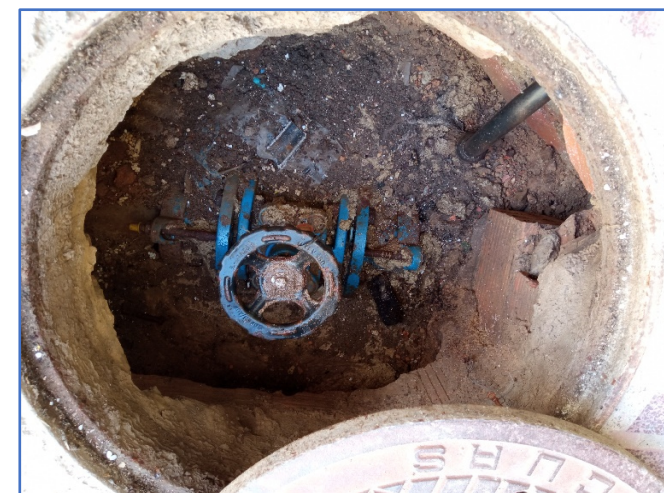
Figura 3: Vàlvula de seccionament existent c/ Montjuic
