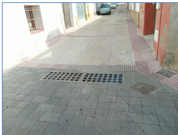
Figura 6: Connexió tram canonada projectada c/ Montjuic nº2 amb arqueta existent de la Plaça (c/ Valls)
