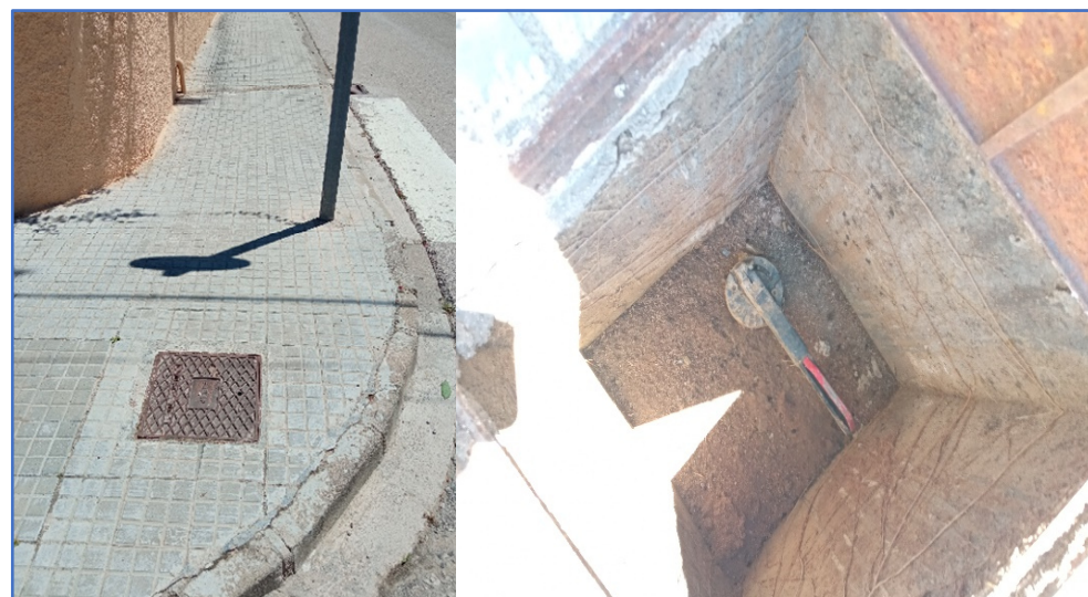
Figura 1: Vèlvules Seccionament existents del c/ Cranc i Av. del Sol
