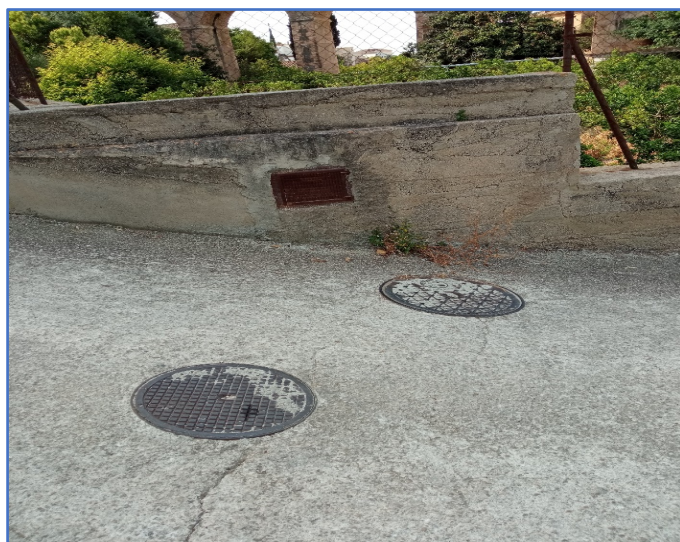
Figura 14: Comptador finca agrícola c/ Valls, i connexió a tram existent PEØ110
