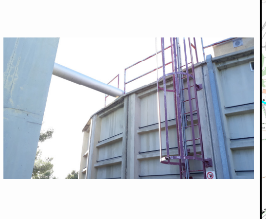
Dipòsit Francasset 2000 m 3
