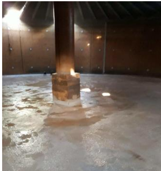
Imatge del interior dels dipòsit durant el manteniment
