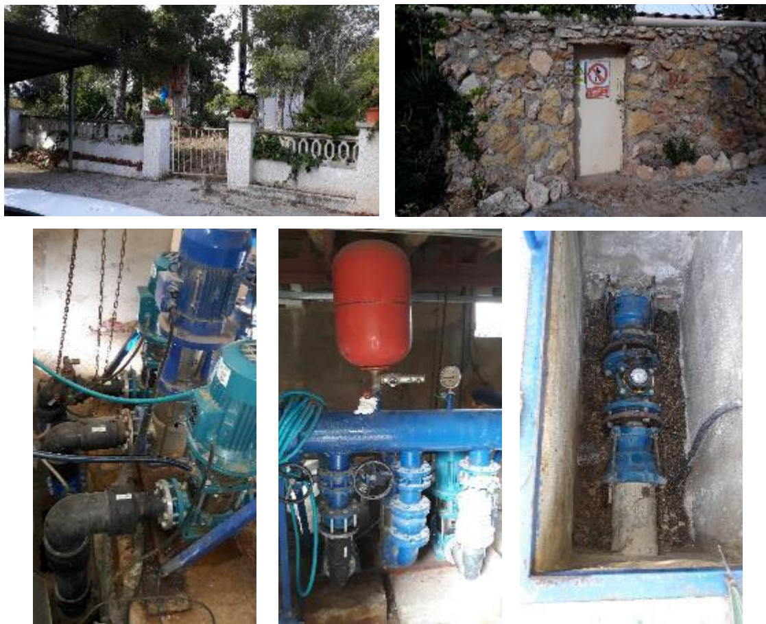
Imatges dipòsit Berà
