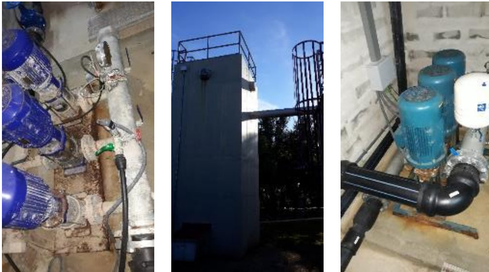
Imatges dipòsit Francasset
