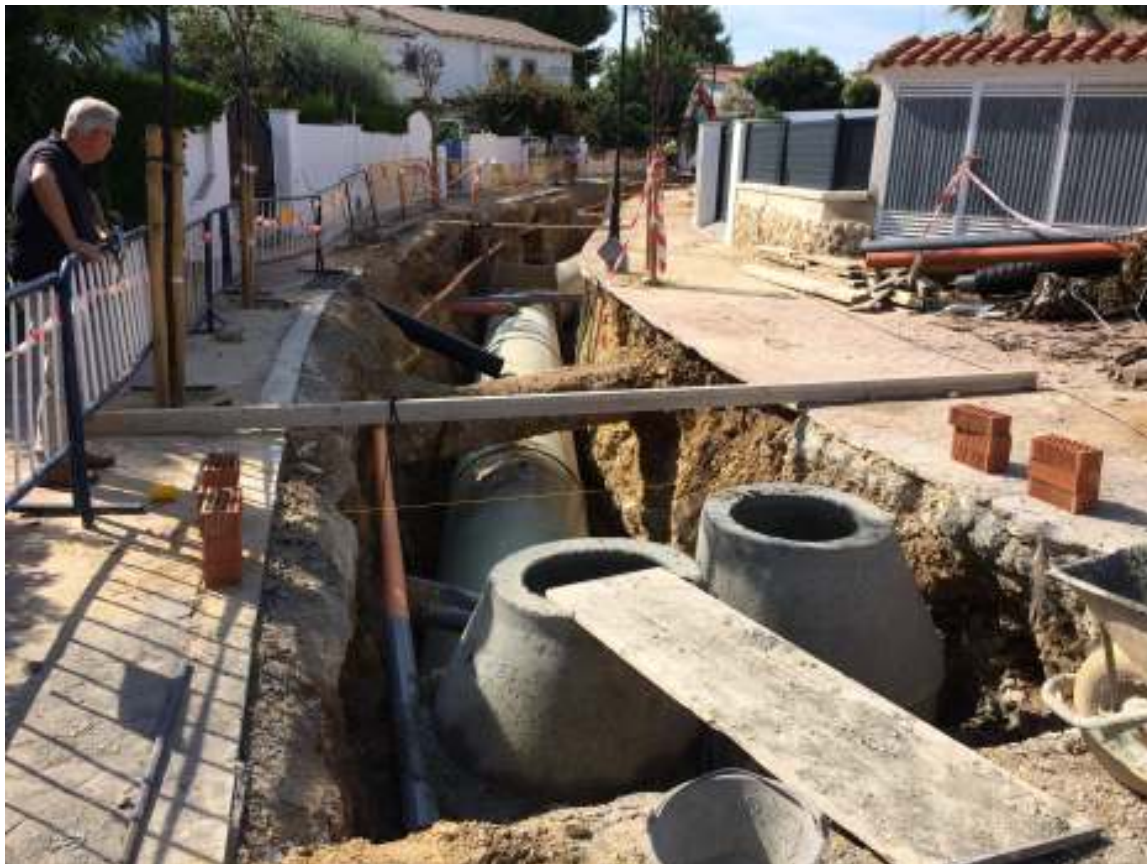
Fotografia 6. Tram del C/ Blanes, amb les obres de caràcter urgent en execució. Es pot observar el nou tub posat en obra i dos nous pous de registre.
