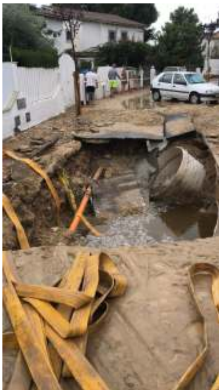
Fotografia 1. Esvoranc provocat per les pluges.
