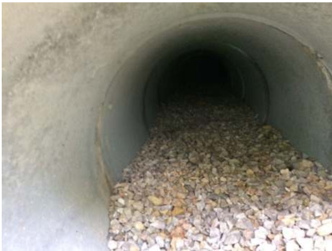
Fotografia 4. Graves arrossegades per les aigües a l'interior d'un tram de col·lector de formigó, contigu al col·lector trencat.
